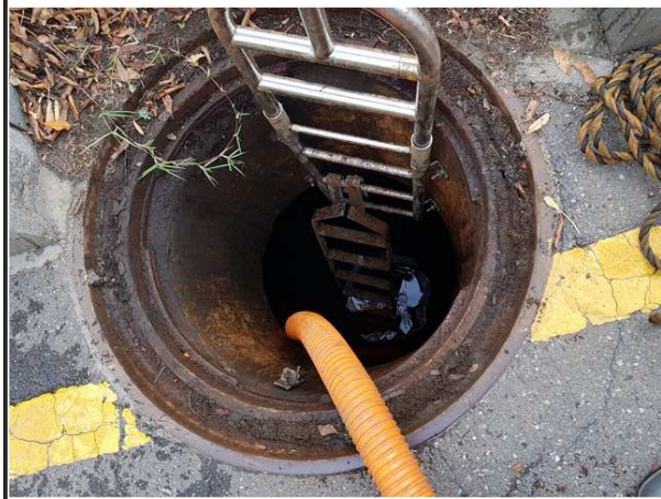
내용 안전손잡이, 안전사다리 상태양호
