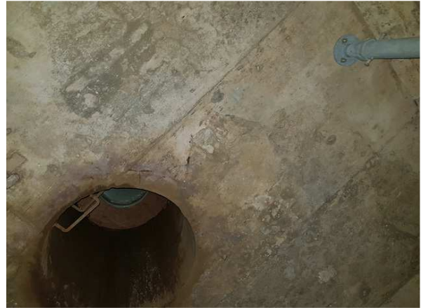
내용 상부슬래브 철근노출
