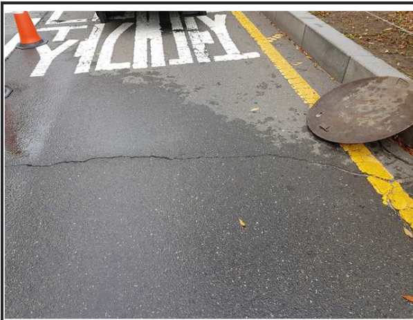
내용 포장부 아스콘 균열
